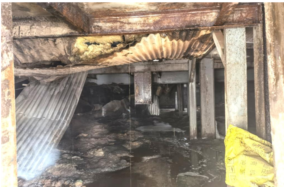
图 1 事故现场图片
