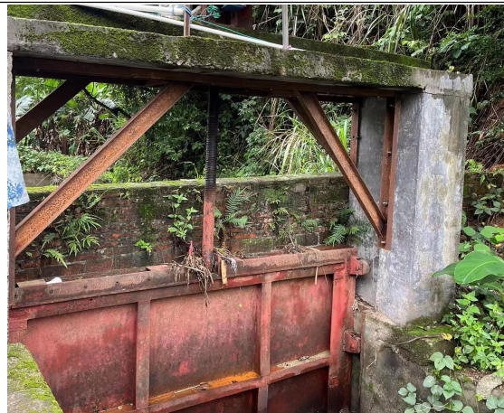
明渠开放水阀
